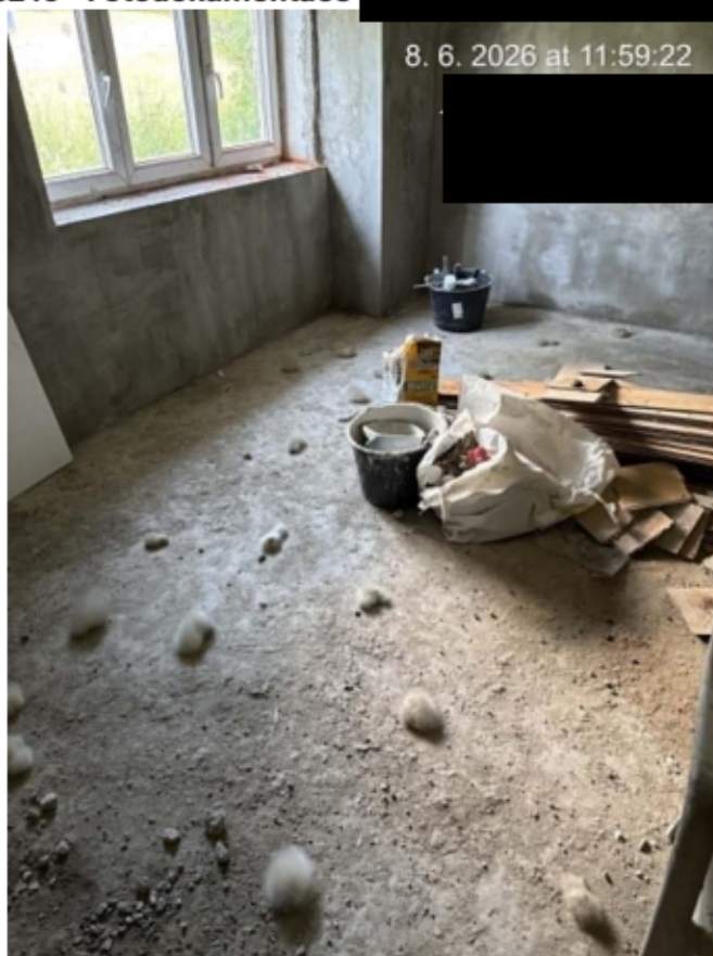
Foto č. 13 – první místnost navazující na chodbu, na zemi výkaly pokryté plísní, odpady, materiál
